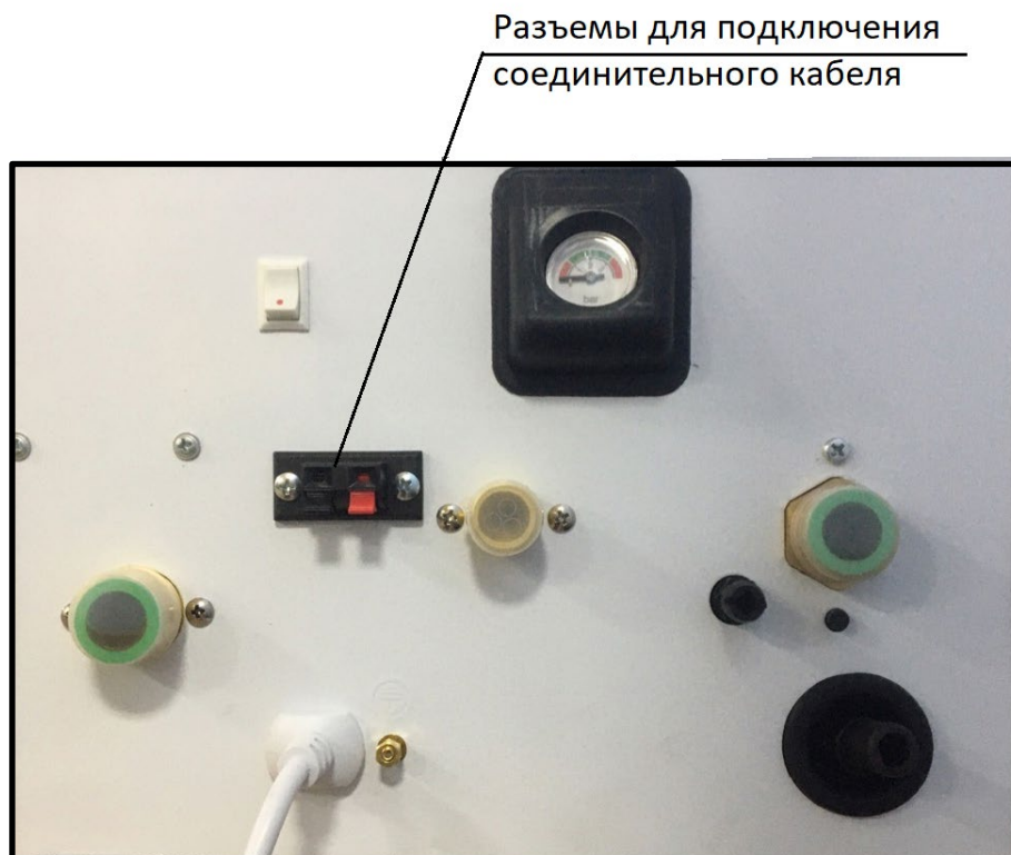
Рис.7 Подключение соединительного кабеля к котлу.
